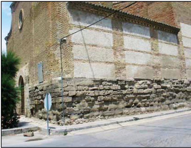
Figura 23. Ascenso de agua por capilaridad y efectos que produce en la base y muros de las edificaciones.
