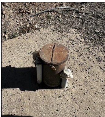
Pozo San Felipe Prolongación 2
