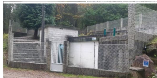
Depósito principal e ETAP.
