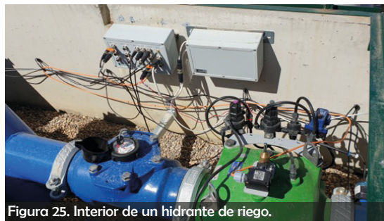
Figura 25. Interior de un hidrante de riego.
