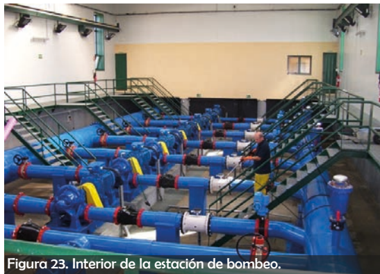
Figura 23. Interior de la estación de bombeo.
