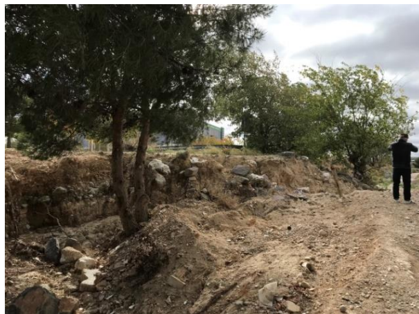
Figura 15. Desperfectos junto a los estribos de la pasarela en la derivación del cauce.
