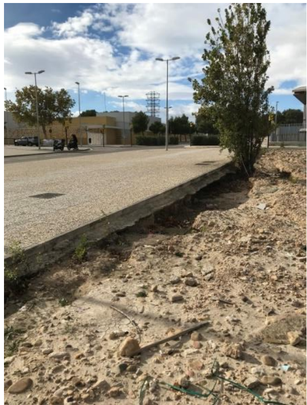
Figura 22. Descalce de plataforma y acera entre el CEIP, el supermercado y el edificio la Policía Local provocado por la erosión de la riada.
