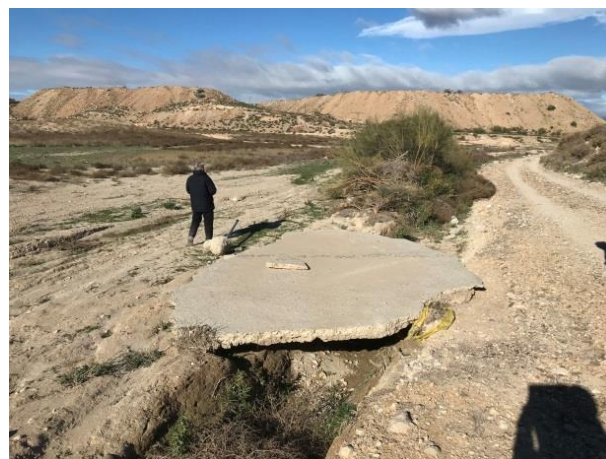
Figura 12. Losa de cemento arrancada y arrastrada por la fuerza de riada.
