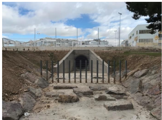
Figura 25. Estado actual del colector del barranco de la Muerte situado en la parte trasera al CEIP María Zambrano.
